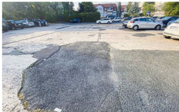
Der Belag ist sichtbar in die Jahre gekommen.
